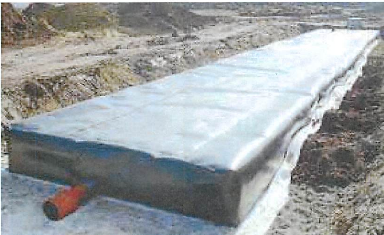
Bild 3: Beispiel Verschweißte Rückhalteeinrichtung aus Speicherboxen mit Reinigungskanal
